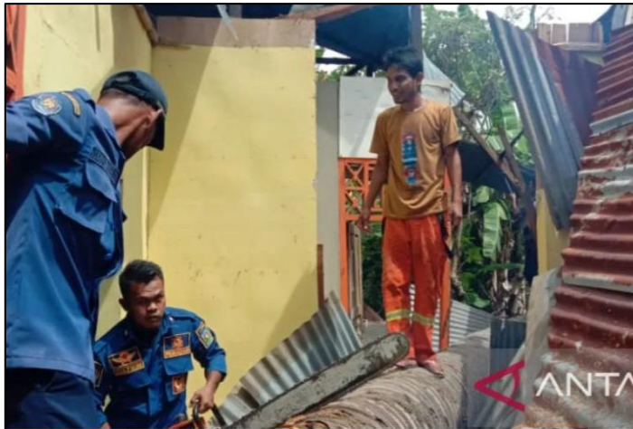
Rumah warga yang rusak tertimpa pohon akibat angin kencang di Desa Atek Lam Ura, Kecamatan Simpang Tiga, Kabupaten Aceh Besar, Sabtu (28/5/2022). (ANTARA/BPBD Aceh Besar)
